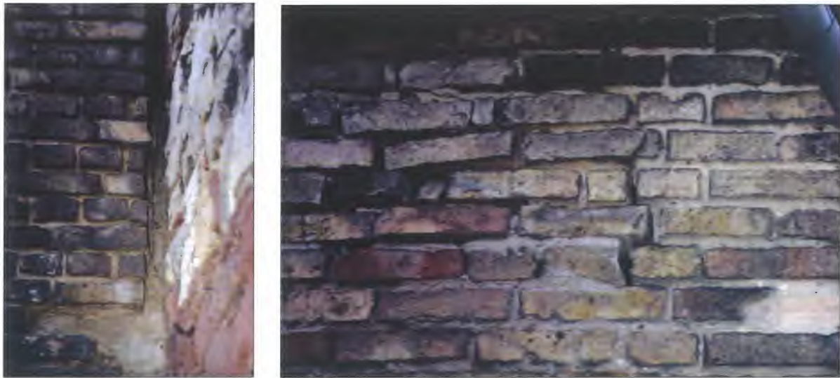
Abbildung 7: Risse an der Außenfassade der Scheune.
