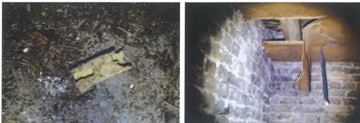
Abb. 11: Fraßspuren unterhalb einer herunterhängenden Deckenabhangung.
