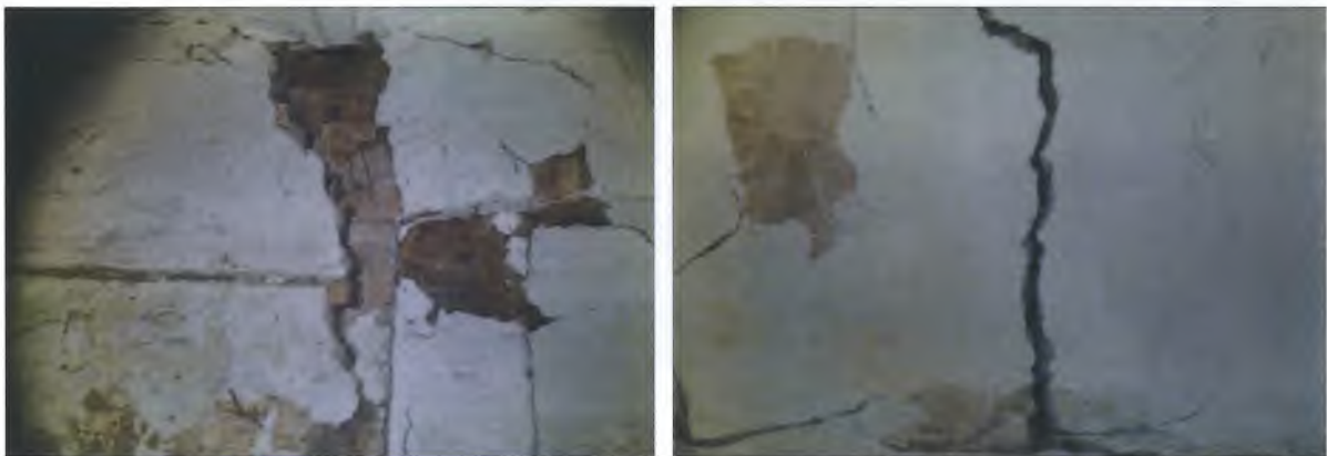
Abb. 10: Beispielbilder der Risse innerhalb der Gebäude, welche Quartierfunktionen für Fledermäuse darstellen.
