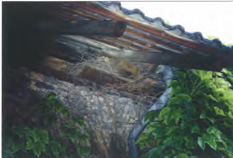
Abbildung 8: Vogelnest unterhalb des Daches der Scheune 1.
