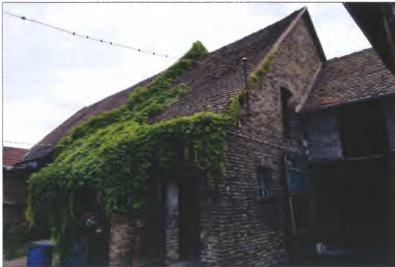
Abbildung 9: Außenfassade der Scheune 2 (Mitte) und der Scheune 3 (rechts) mit ungeschlossenen Öffnungen.
