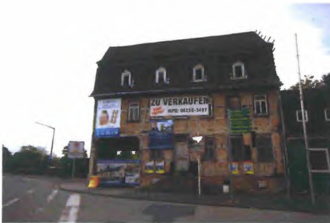
Abbildung 16: Gebäude mit hohem Sanierungsbedarf
