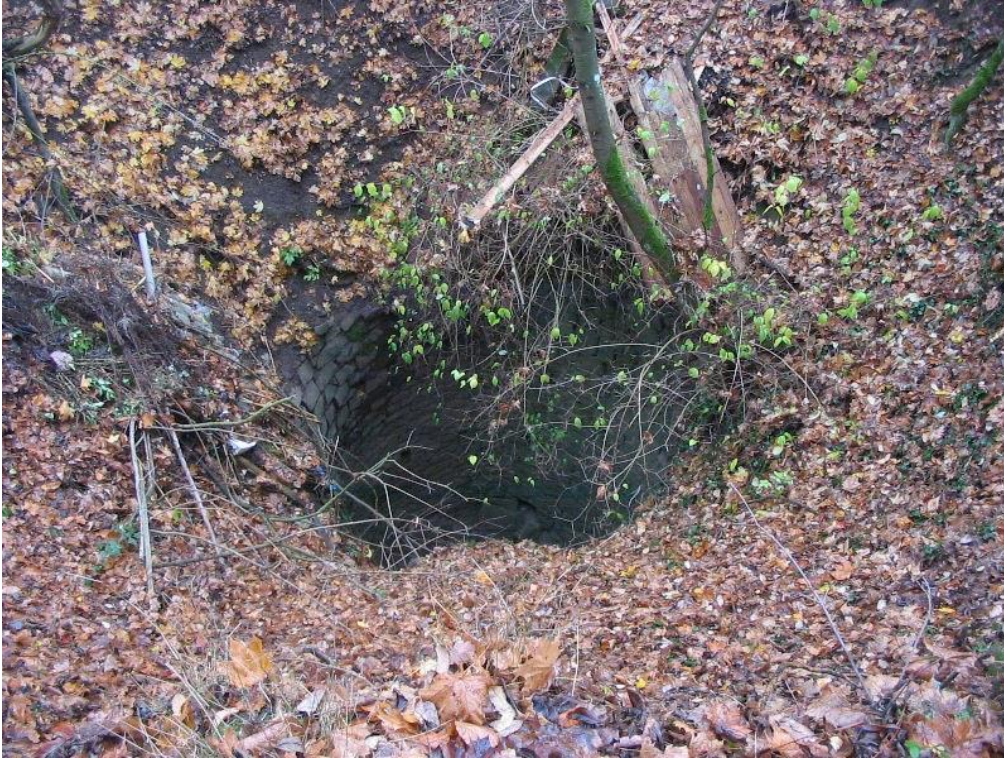
Abb. 11: Offener Schacht des Stollenabschnitts „Teddy“ in Niedermendig. Die Schächte sind mehr als 25 m tief und oftmals nur durch einen Zaun gesichert.
