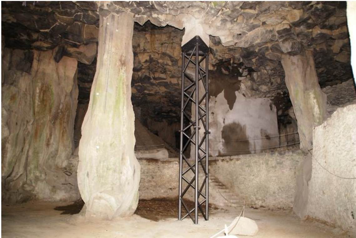
Abb. 17: MAYKO-Bierkeller im Mayener Grubenfeld. Die Stahlsäule (ca. 10 m hoch) und die dahinter befindliche Betonsäule wurden im Rahmen des Naturschutzgroßprojektes als Sicherungsmaßnahme eingebaut.
