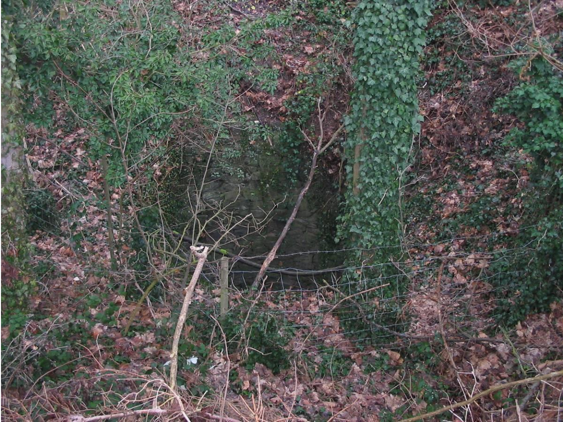
Abb. 10: Dieser Schacht (Nr. 2) ist vollständig geöffnet und bietet eine optimale Bewetterung. Allerdings ist die Einzäunung unzureichend. Hier werden auch aktuell immer wieder Grünschnitt und Müll in den Schacht entsorgt.
