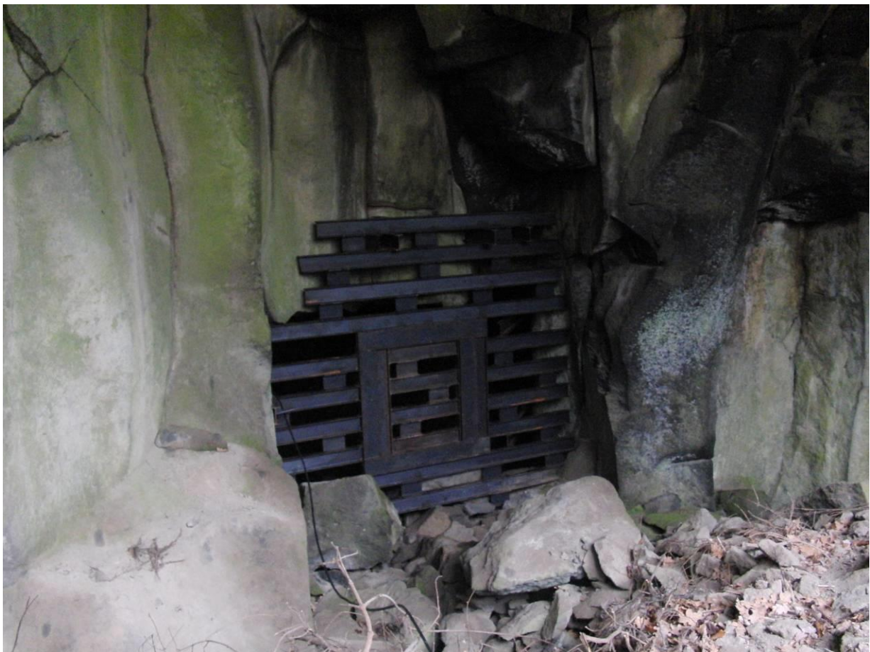
Abb. 12: Die massive Vergitterung von kleinen Eingängen (hier in Mayen) ist eine wichtige Maßnahme des Schutzkonzeptes.
