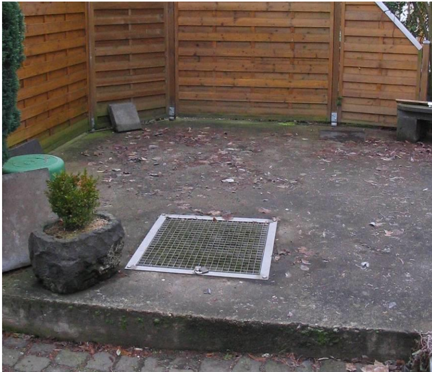
Abb. 9: Dieser Schacht (Nr.4) wurde größtenteils mit Beton verplombt, aber eine kleine Fläche wurde mit einem Gitter offengelassen. Zur besseren Bewetterung wäre eine deutlich größere Öffnung des Schachtes wünschenswert. Auch können durch das Gitter keine Fledermäuse in den Schacht einfliegen. Eine Aufmauerung als offener Kamin wäre eine deutliche Verbesserung gegenüber dem Ist-Zustand.
