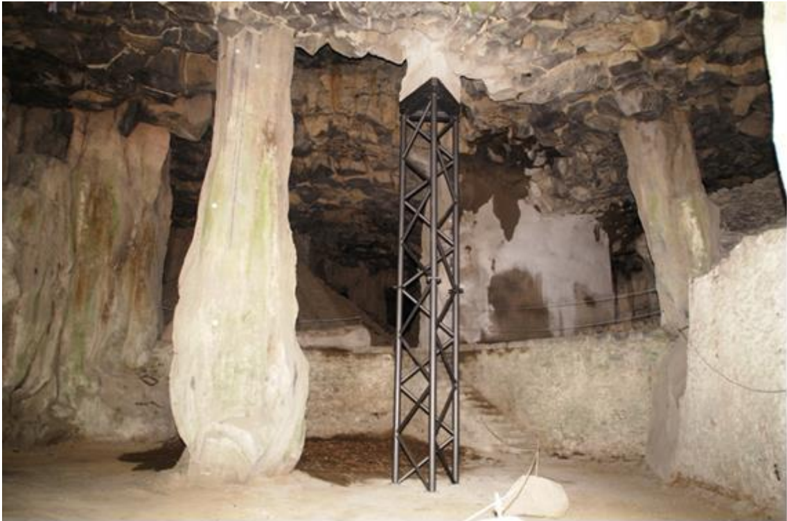
MAYKO-Bierkeller im Mayener Grubenfeld. Die Stahlsäule (ca. 10 m hoch) und die dahinter befindliche Betonsäule wurden im Rahmen des Naturschutzgroßprojektes als Sicherungsmaßnahme eingebaut.
