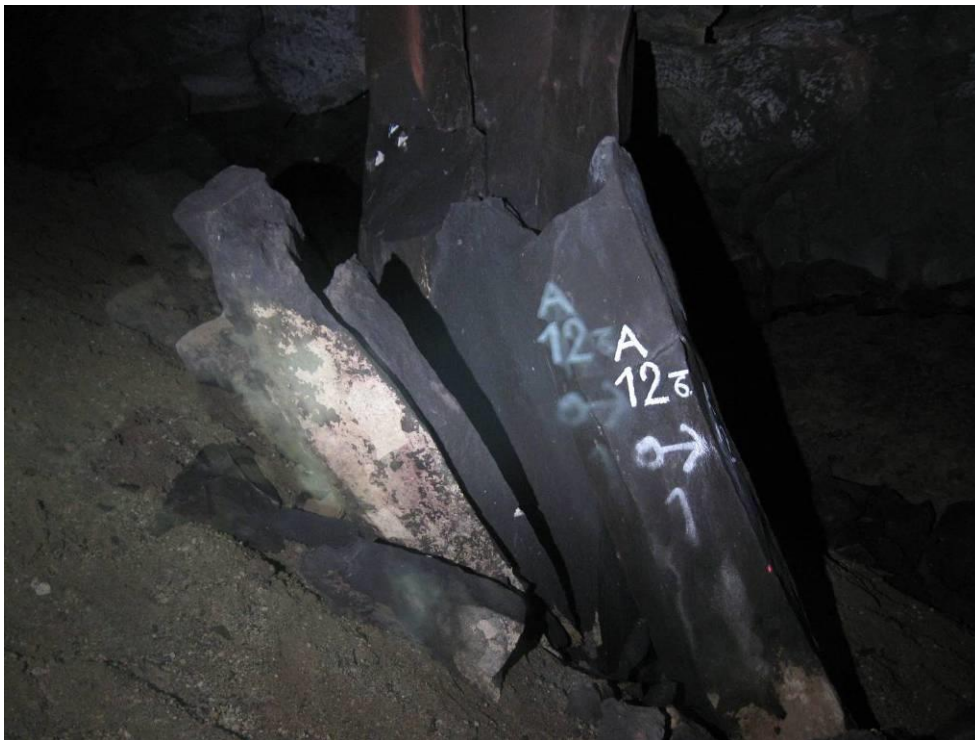
Abb. 6: Instabile Säule im Bereich des A-Flügels unweit der Brauerstraße. Diese instabilen Bereiche müssen zukünftig im Rahmen eines Gesamtkonzeptes stärker überwacht werden, um Gefahren für Menschen und Tiere abzuwehren.
