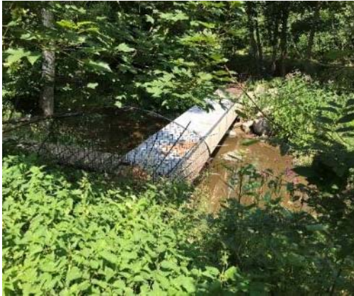
Bild 38: Nitztal 11, Rohrquerung MW-Kanal zu tief
