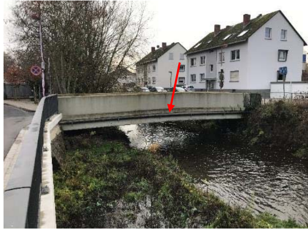
Bild 30: Mayen 18, Brücke ragt ins Gewässerprofil
