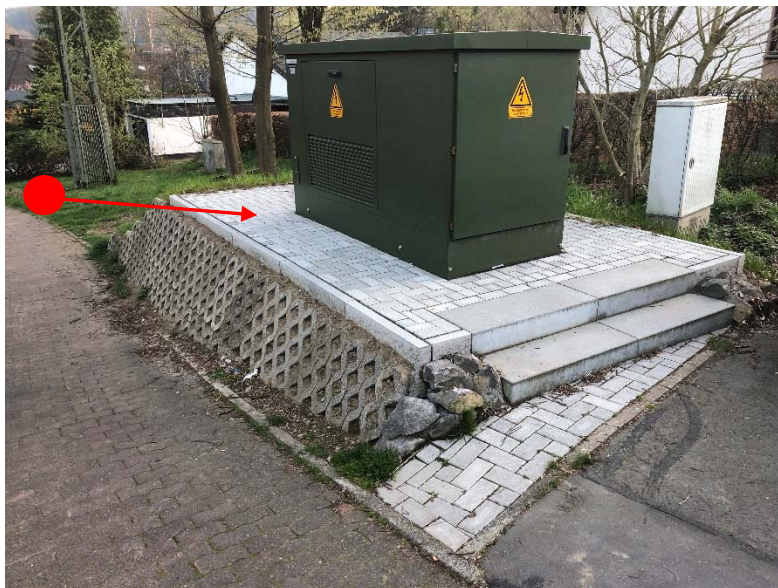
Abbildung 44 erhöhte und verschobene Transformatorenstation
