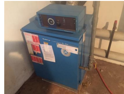
Kesselanlage Bereich Wohnungen
