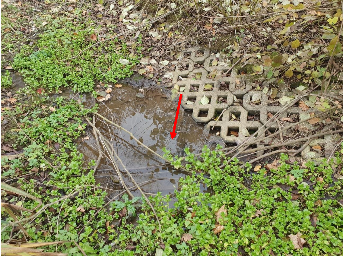
Abb. 3: Auslaufbereich in das Feuchtbiotop (zugelegt/verschlammt)
