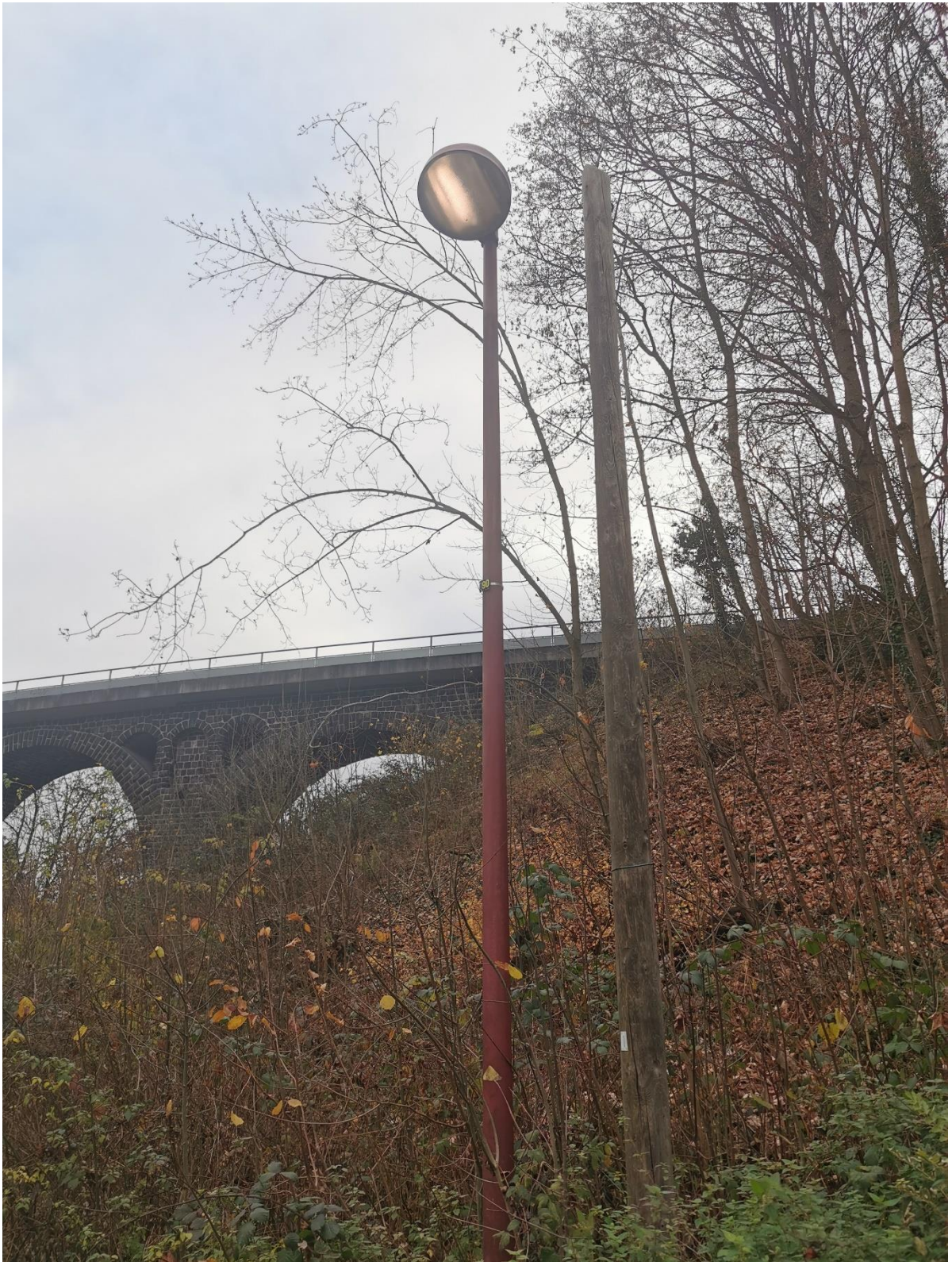
Abbildung 6: Technische Leuchte mit Leuchtstofflampen (n), wahrscheinlich in Halbnachtschaltung, 1 Lampe ist aus
