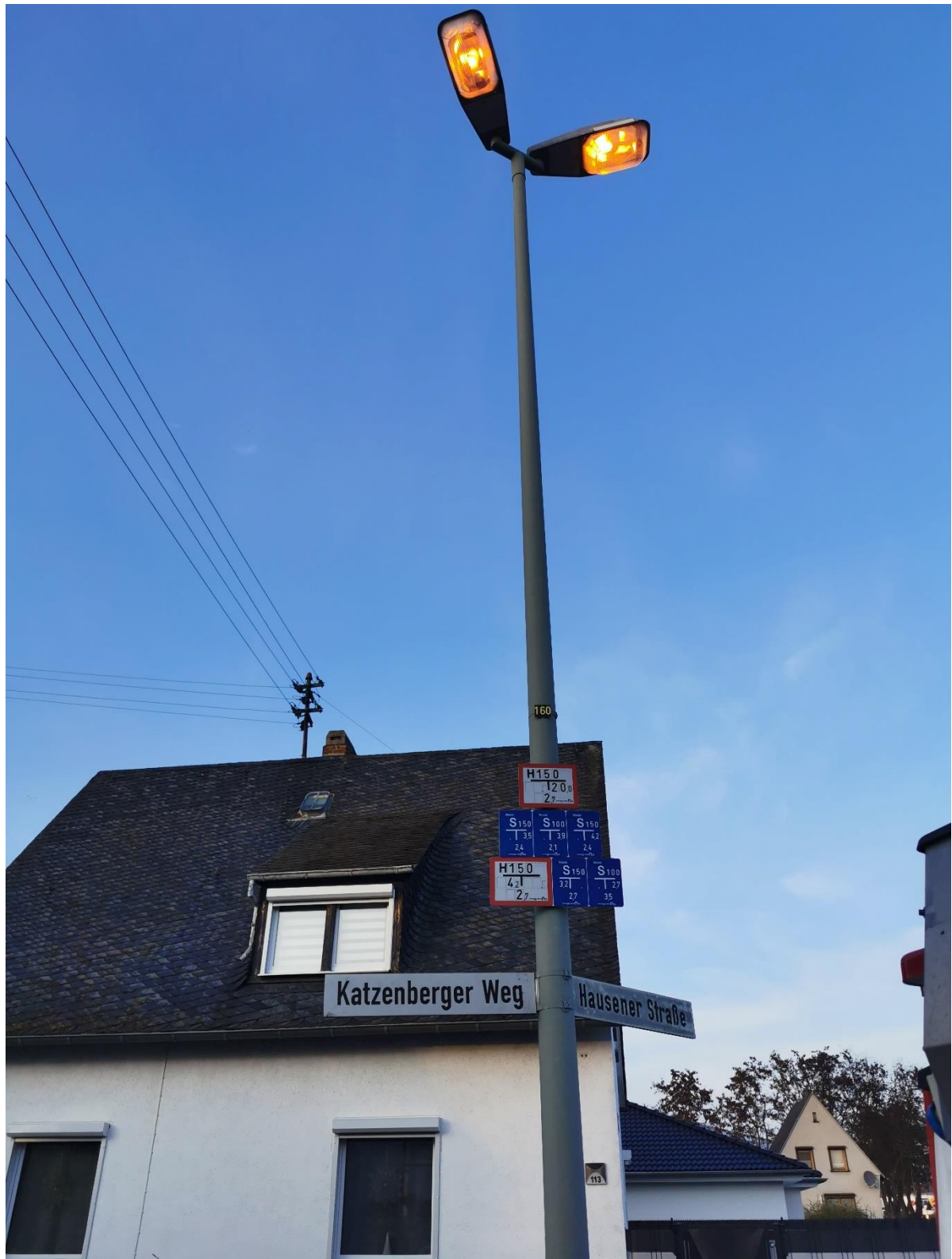
Abbildung 7: Technische Leuchte mit Natriumdampfampe (gelbes Licht)
