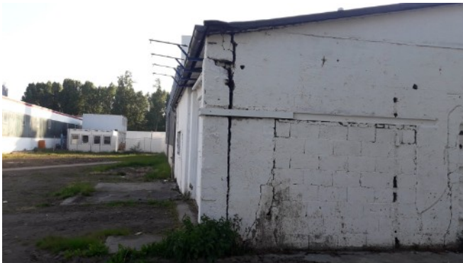
Abbildung 30: Halle in TF1, Mauerriß
