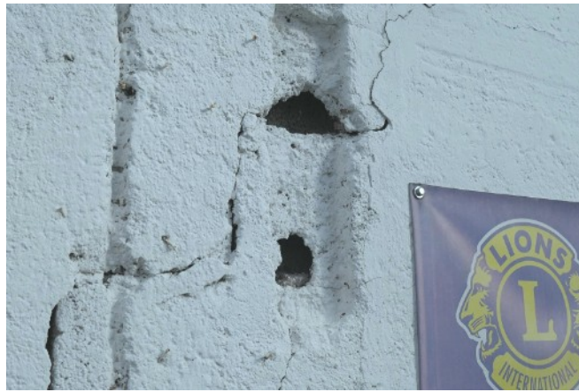
Abbildung 32: Mauerlöcher mit kleinen Hohlräumen (TF1)
