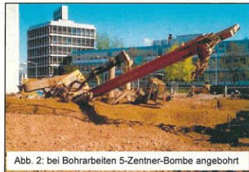
Abb. 2: bei Bohrarbeiten 5-Zentner-Bombe angebohrt
