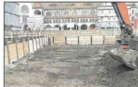
Abb. 4. Schichtenweiser Abtrag, verpflichtend bei baubegleitender KMR
