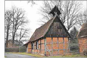
Die Kapelle Metel aus dem Jahr 1534 ist sanierungsdringlich. Döpke (Ar-
