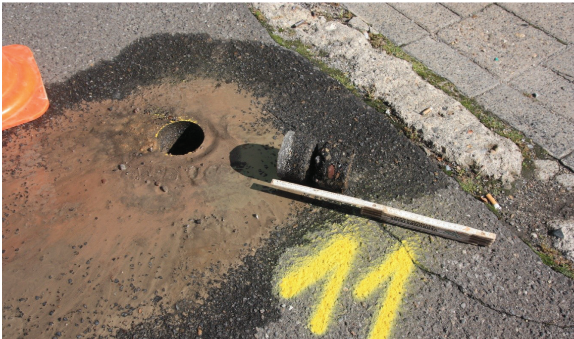
Abb. 6-1: Bohrkern bei RKS 11 (beispielhaft), 14 cm Asphaltbefestigung, teerhaltig
