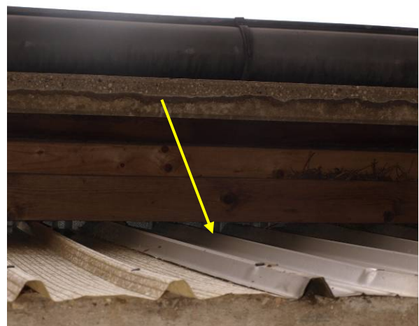
Dachüberstand im 4 m Höhe am Gebäude 3.1 Nordostseite im Alten Gutshof - für 6 Fledermauskästen
