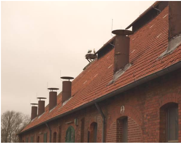
Weißstorchhorst auf Gebäude 16 des (ehem.) Alten Werkhofs (März 2014)
