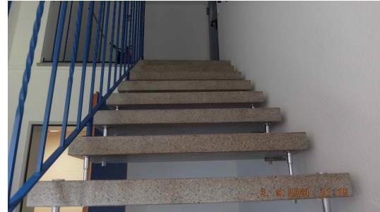
Bild 10: fehlender Aufzug für die obere Etage
