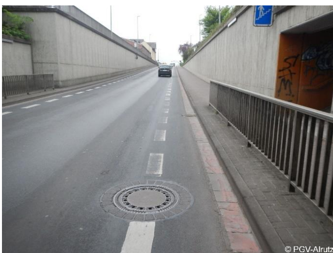
Landwehr Unzureichende Breite der Radverkehrsanlage
