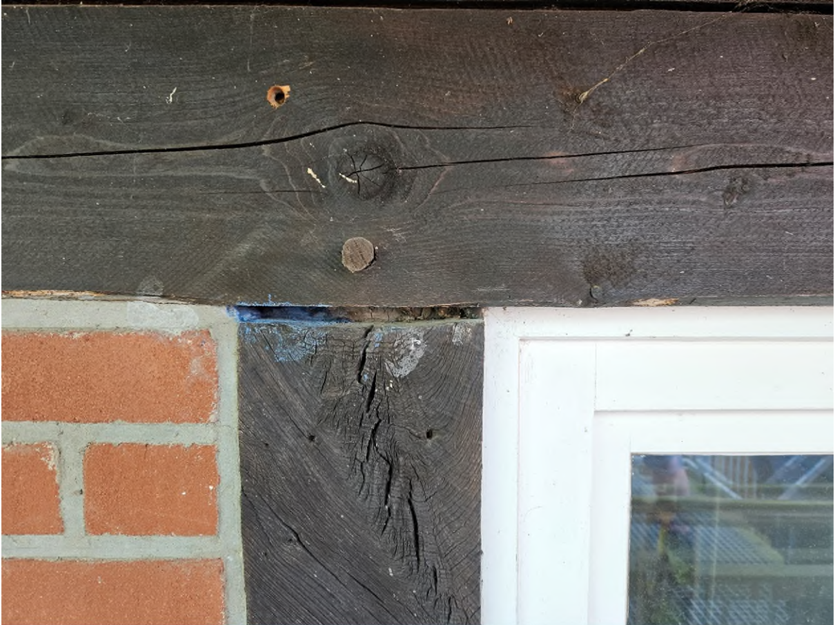
Westseite – Fugenspalte an Balken
