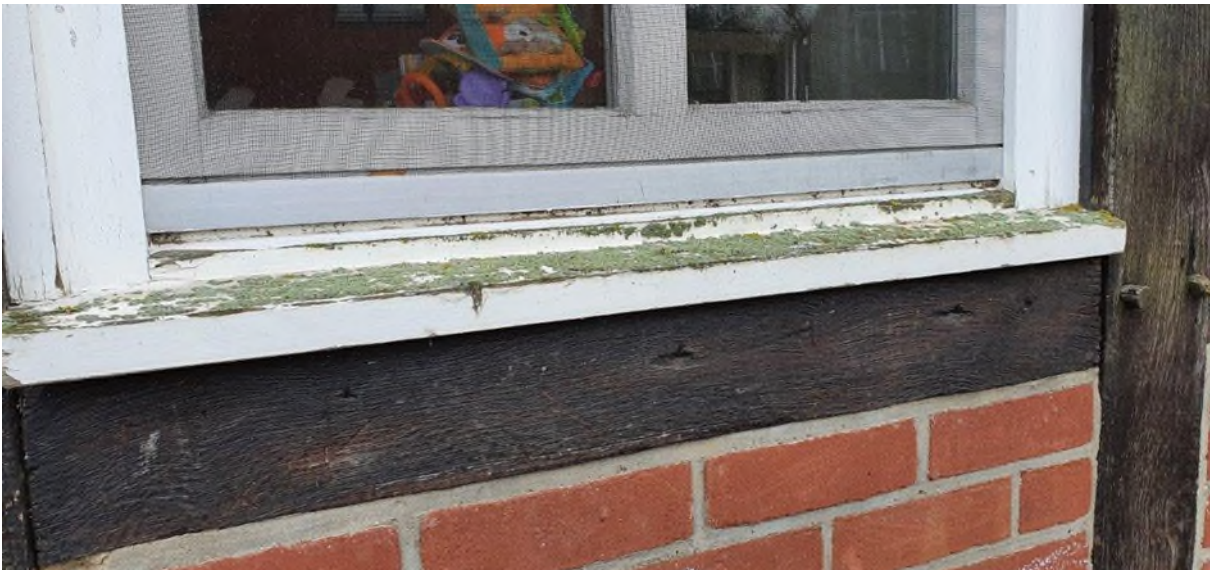
Westseite – Verwitterung Fensterbänke
