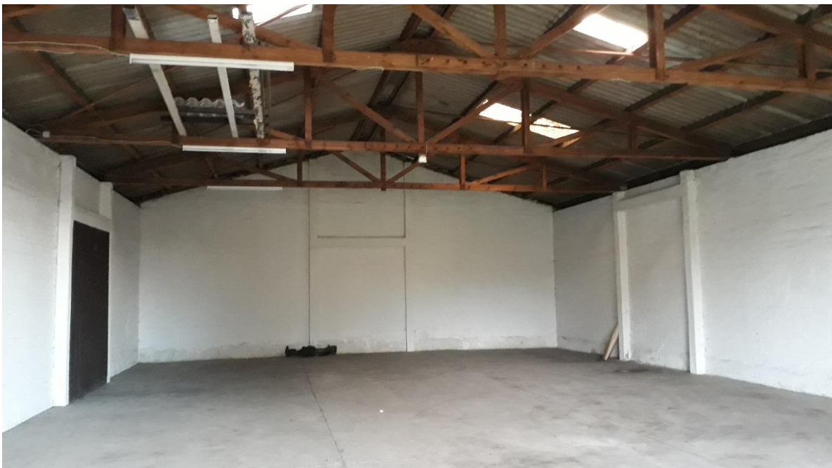
Abbildung 2-9: Die Lagerhalle von innen
