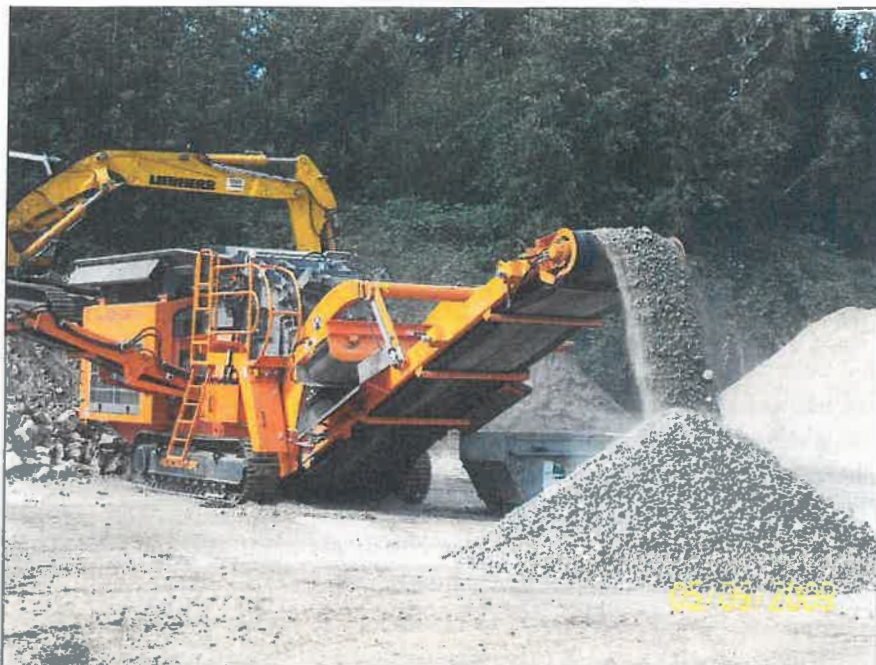
Abbildung 2 Brecheranlage Rockster R1100 (Quelle: Kormann Rockster Recycler)
