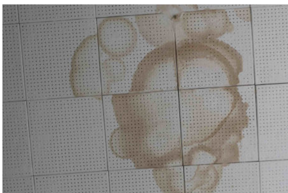
Raum R.00.05 : ehem. Wasserschaden
