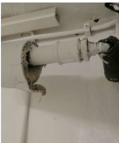
Flur: defekte Ummantelungen
