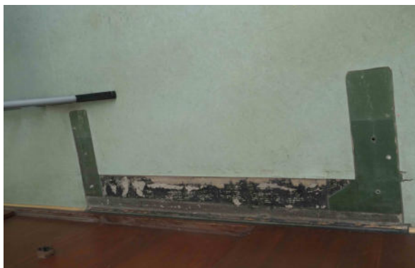
Raum R.00.05 : Fehlstelle Bodenbelag
