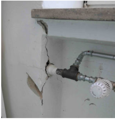
Klassenraum mit Spielecke: Risse in MW
