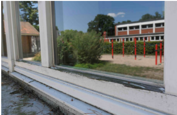
Anbau C: defekte Beschichtung
