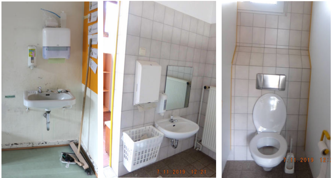
Sanitärinstallationen im EG: links Klassenraum, Mitte + rechts WC-Räume Seitenflügel
