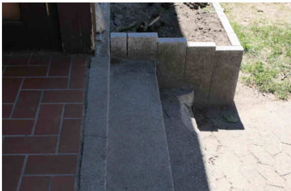
Seitenflügel B: defekte Treppenstufe
