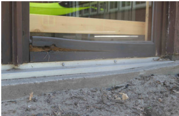
Seitenflügel B: stark geschädigte Rahmen
