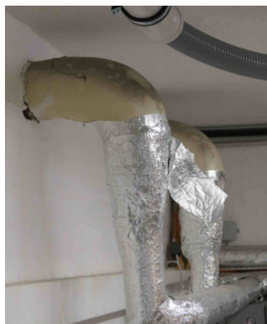
Heizung: gelöste Verklebungen
