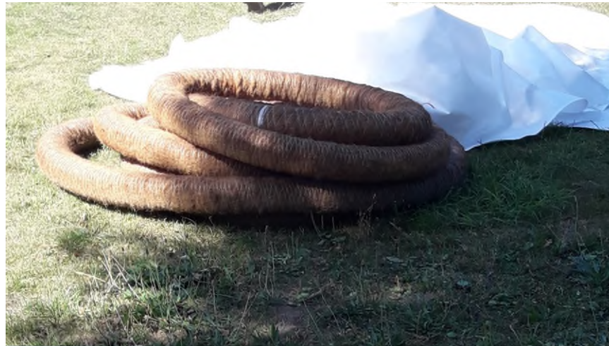
Falsch angeschlossene Drainagen
