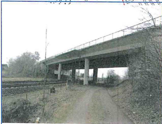
Bauwerk über die DB-Strecke 1740 im Zuge der B6 OU Neustadt ASB-Nr. 3422504, P185928
