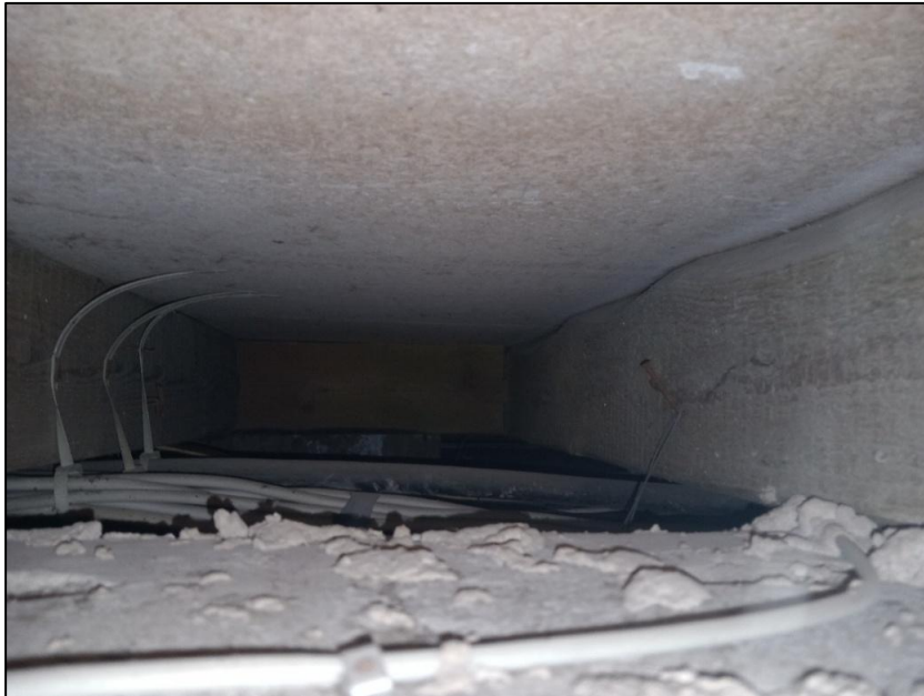
Abbildung 6: Leerer Kabelschacht an der Dachkante (s. Abb. 5).
