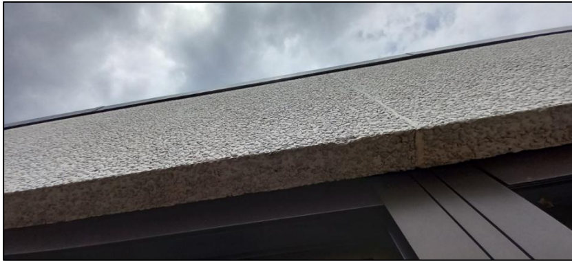
Abbildung 27: Weiterer Bereich zwischen Fenster und Fassadenplatte.
