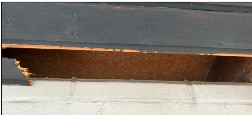
Abbildung 5: Spalte an einer Dachkante.
