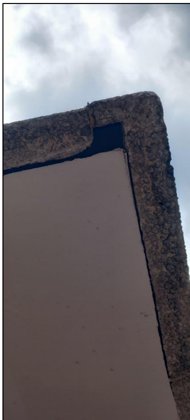
Abbildung 28: Hohlraum zwischen Fassadenplatte und Gebäudewand.
