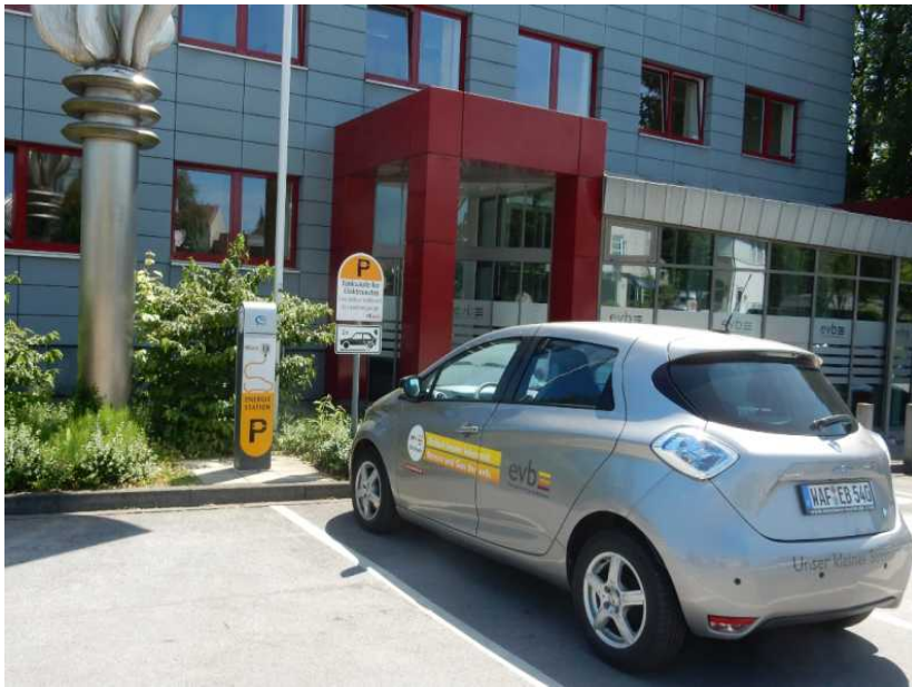
Abbildung 112 – E-Ladestation am Hindenburgplatz in Beckum
