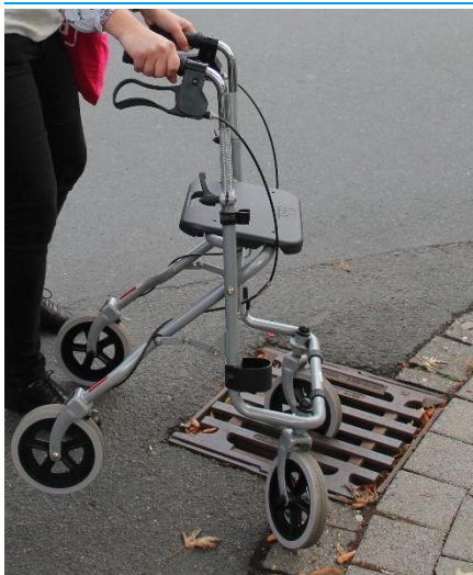
Abb. 6: Nicht barrierefreie Abdeckung eines Straßenablaufs an der Clemens-August-Straße
