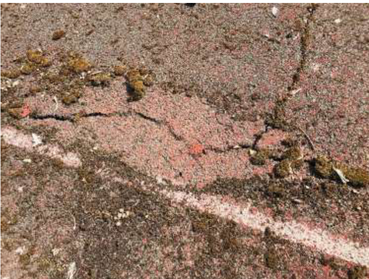
Bild 4: Nahaufnahme eines Risses
