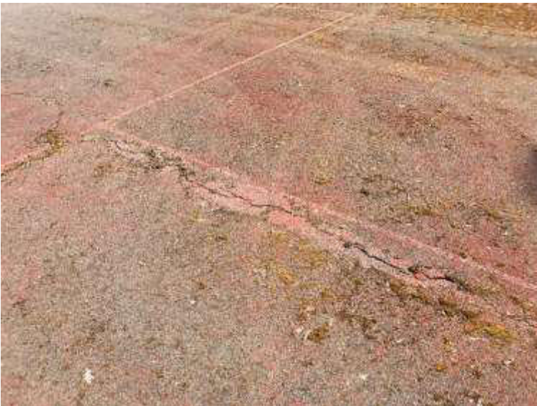
Bild 3: Beispiel eines Risses
