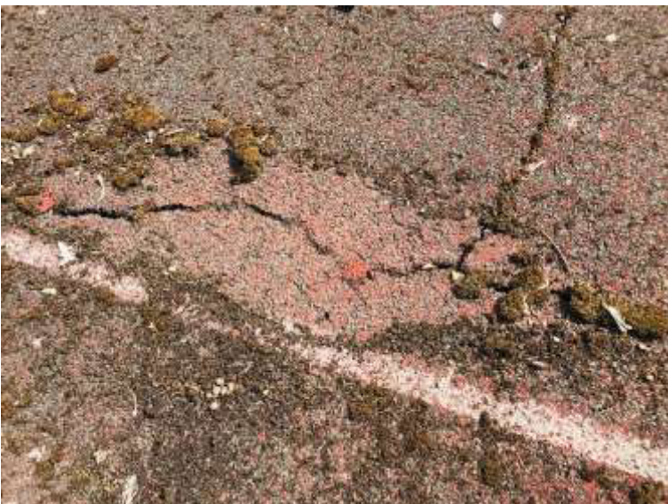
Bild 4: Nahaufnahme eines Risses
