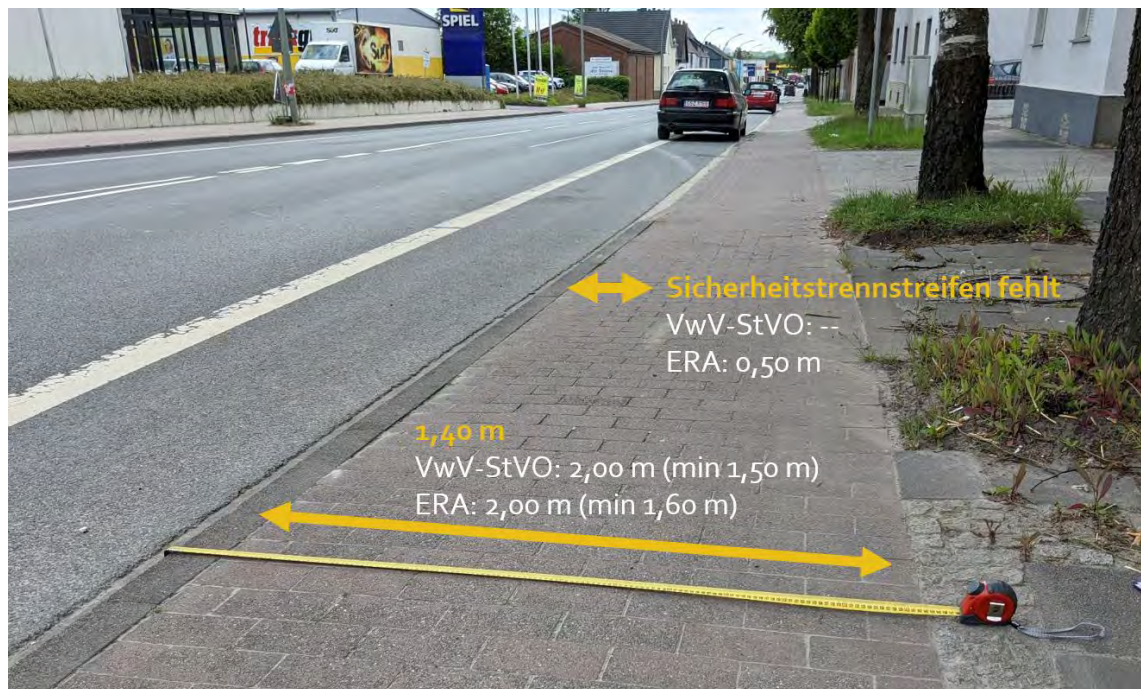
Abbildung 19 - Nicht StVO-konformer benutzungspflichtiger Radweg entlang der Neubeckumer Straße
