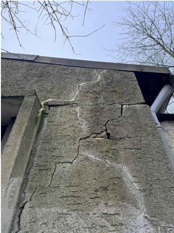
Massive Schädigungen der tragenden Außenwände
