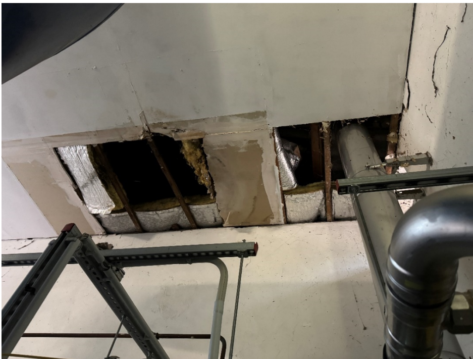
Durchnässte Mineralwolle und Zwischendecke
