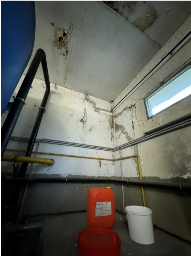
Feuchtigkeitseinträge durch Dachkonstruktion und Wände.
