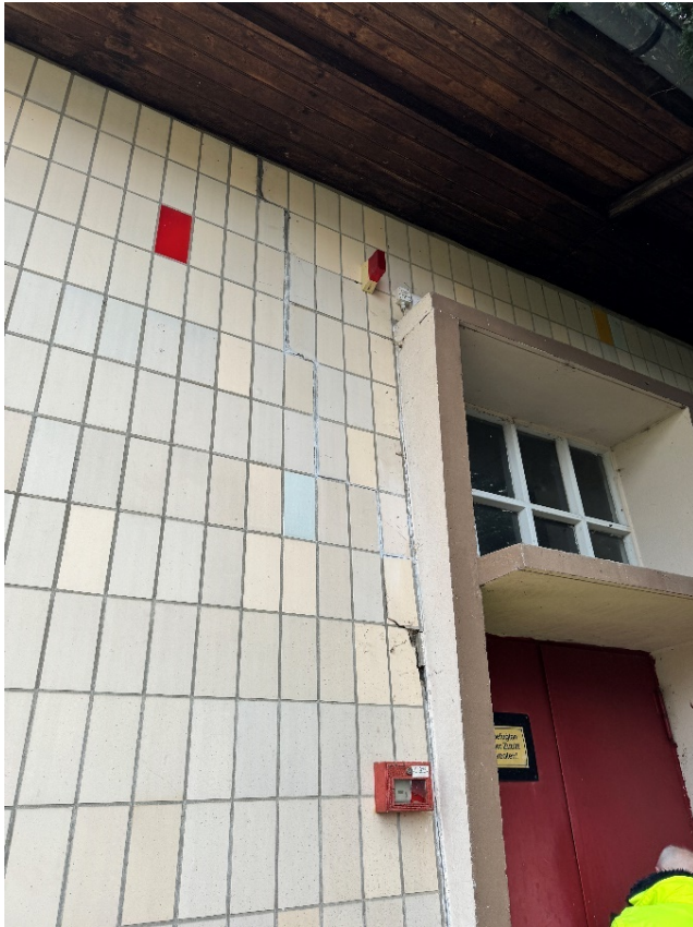
Rissbildungen neben Zugangstür Technikgebäude
