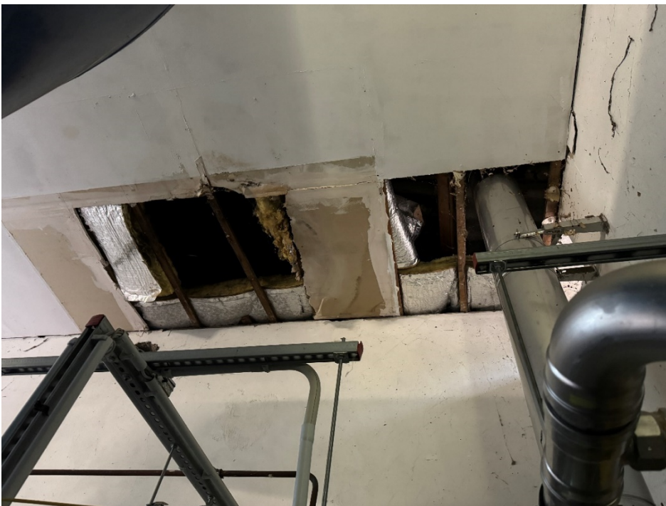
Durchnässte Mineralwolle und Zwischendecke
