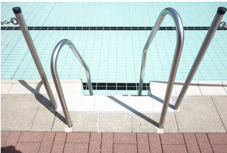
Leiternische mit rechts und links platzierten Edelstahlhandläufen
