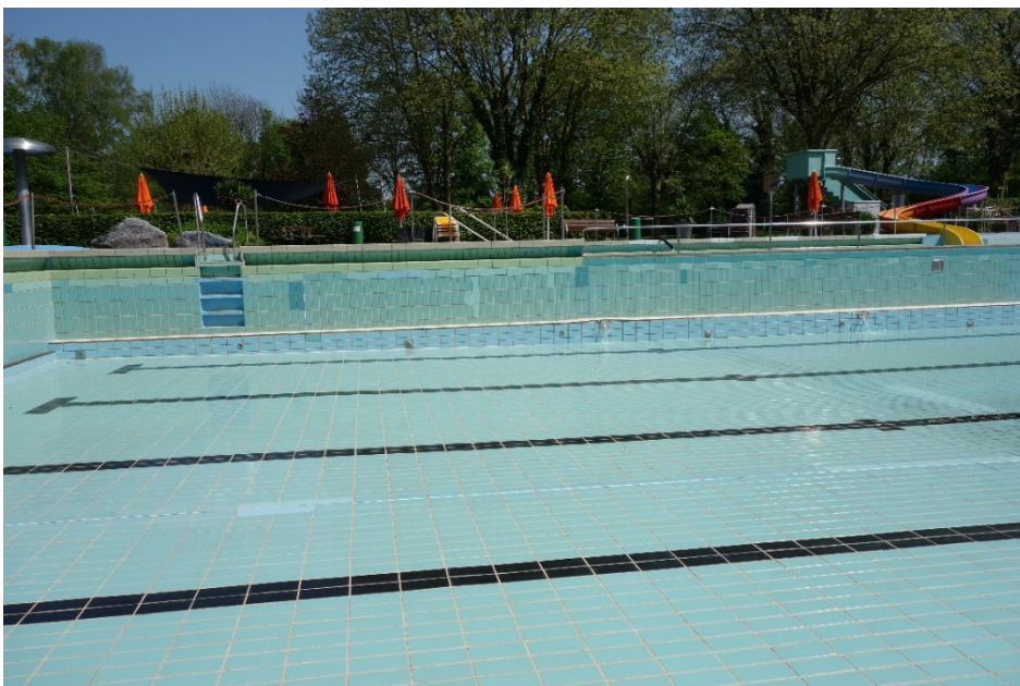
Beckenlängsseite zu Nichtschwimmerbecken mit Leiternische und seitlichen Einströmdüsen
