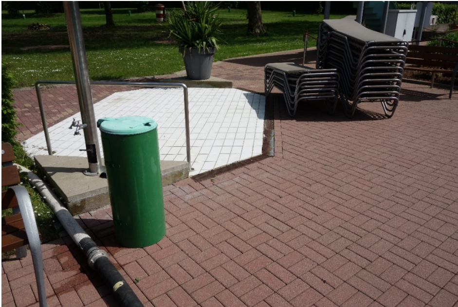
Zugangsbereich Badeplatte, Durchwatebecken vor Liegewiese
