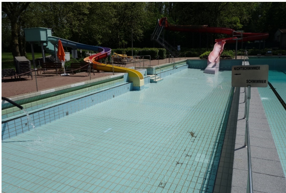
Nichtschwimmerbecken mit seitlichen Einströmdüsen
