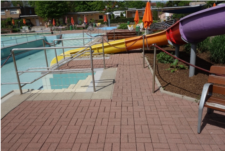
Beckeneinstiegstreppe zwischen Rutschenanlagen
