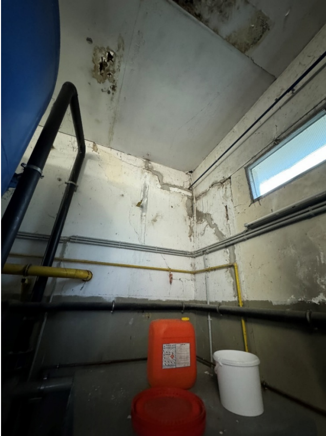
Feuchtigkeitseinträge durch Dachkonstruktion und Wände.
