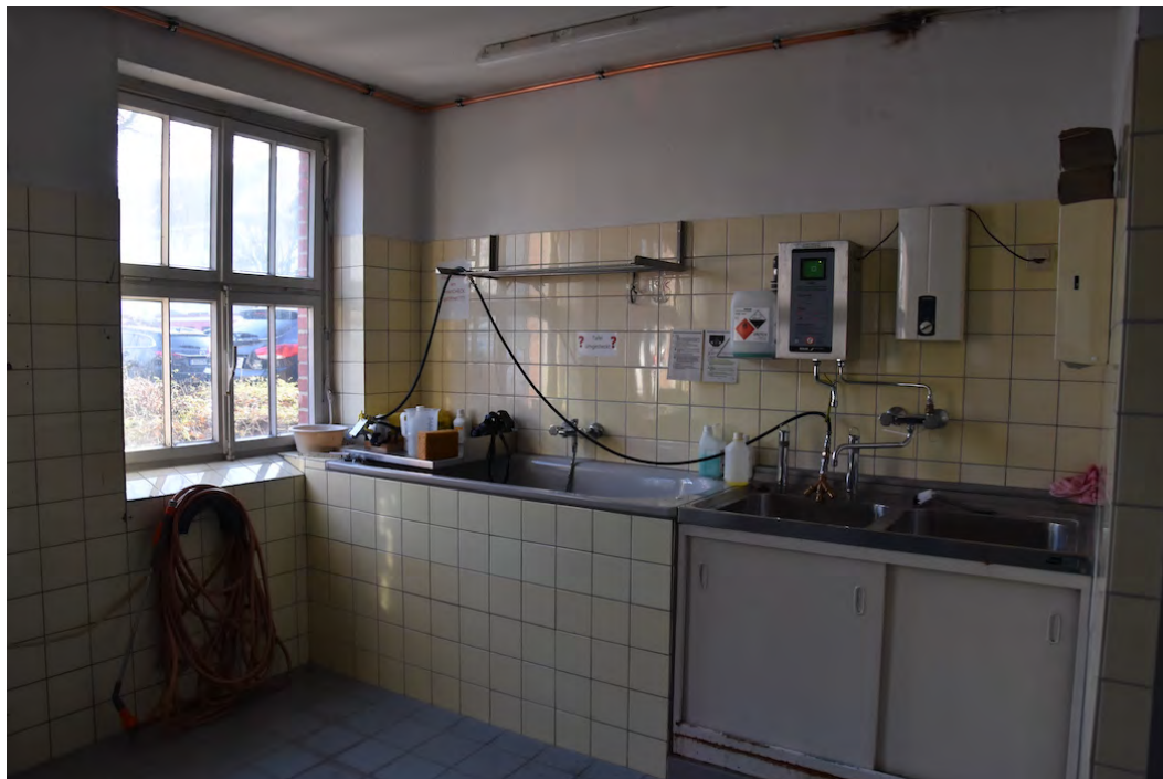
Abb. 7.5-2: Fw Beckum: Reinigungs- und Desinfektionsbecken in der Atemschutzwerkstatt
