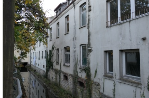
Abb. 8 Gebäude mit erheblichem Sanierungsbedarf Südwall 1-7 (Bildquelle: scheuvens + wachten plus)
